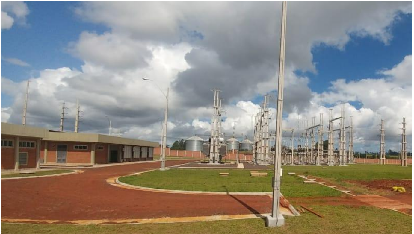
Construcción e Interconexión de la Subestación Fram 66 kV - Licitación Pública Nacional ANDE N° 1200/2016 - Lote 1 - BONOS II
