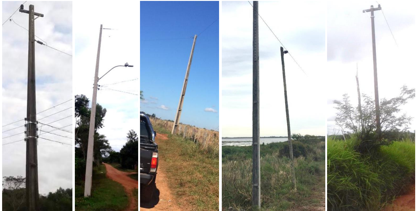
Ejecución de trabajos de normalización de líneas de autoayuda en MT y BT, en los Dptos. de Guairá, Misiones y Paraguarí – Licitación Pública Nacional ANDE N° 1169/2015 - Lotes 1, 2, 3, 4 v 5 - BONOS II
