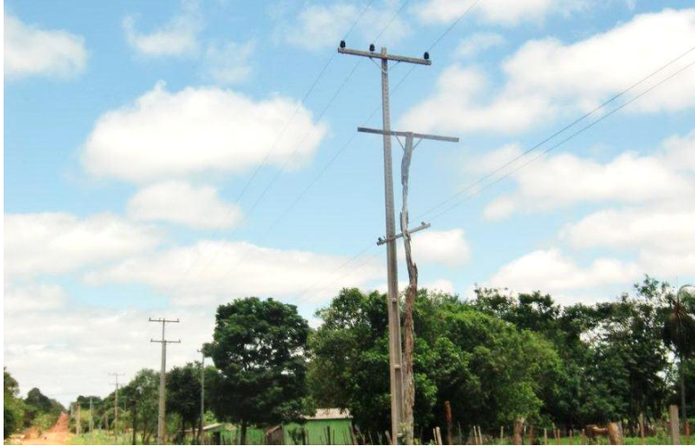
Ejecución de Trabajos de Normalización de Líneas de Autoayuda en MT y BT Canindeyú, Maracaná - Licitación Pública Nacional ANDE N° 969/2014 - BONOS I
