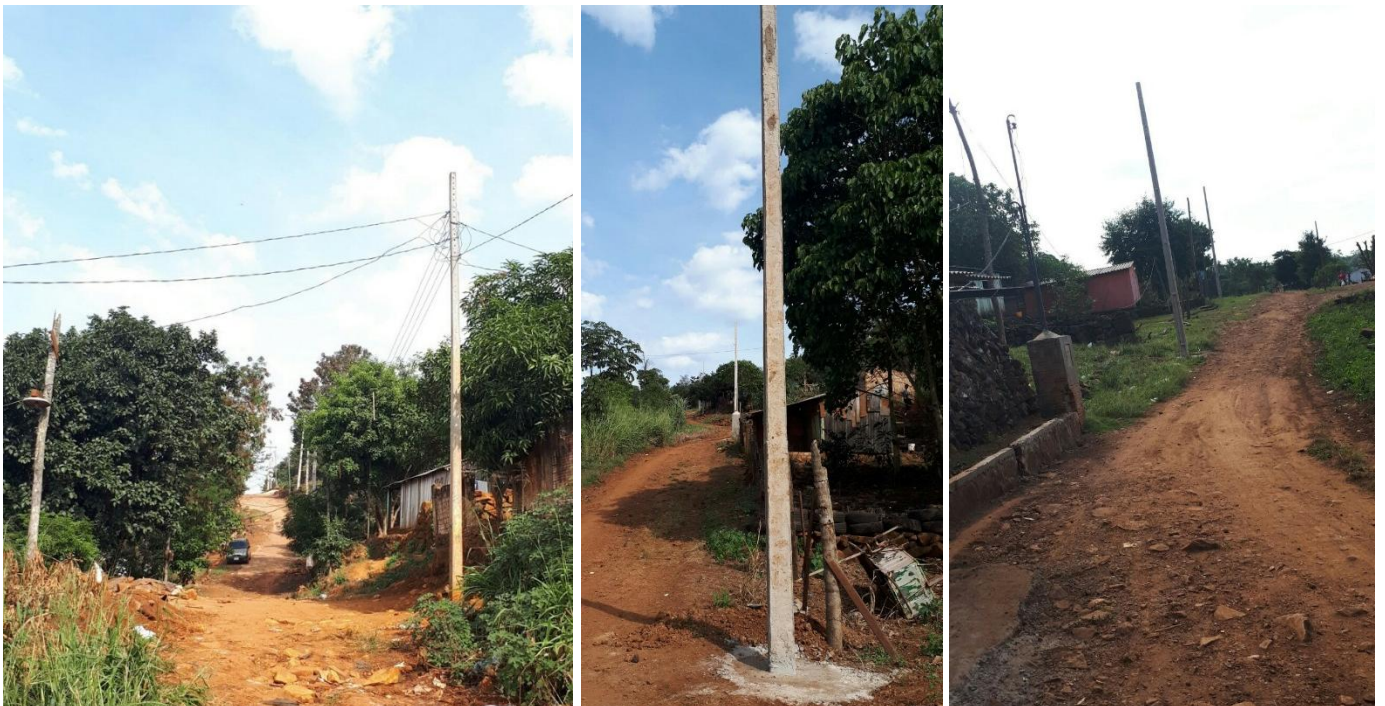
Construcción de Redes de MT, BT y Montaje de PD. Licitación por Concurso de Ofertas N° 956/2017, Asentamiento de Mcal. López-km4, del Distrito de Ciudad del Este – Lote 3 – BONOS II
