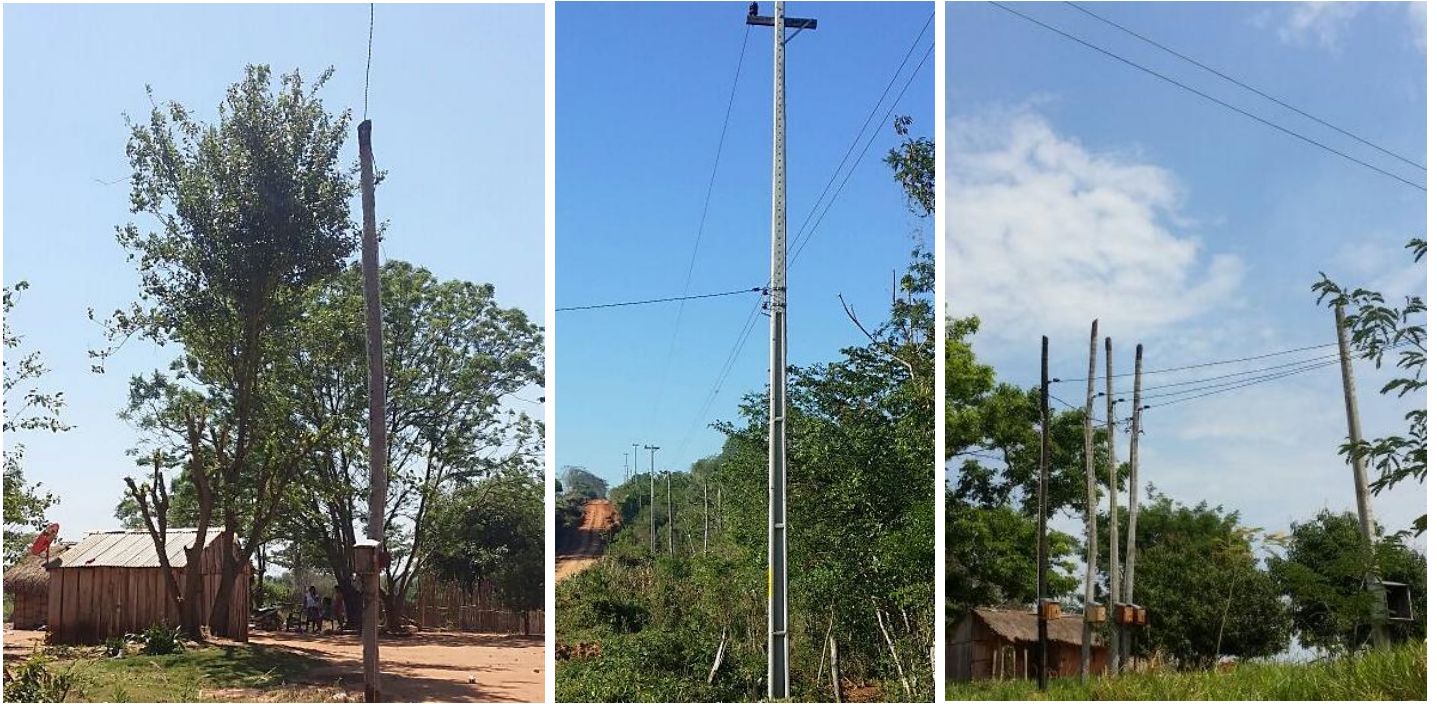
Ejecución de Trabajos de Normalización de Líneas de Autoayuda en MT y BT Canindeyú - Licitación Pública Nacional ANDE N° 1008/2014 - BONOS I
