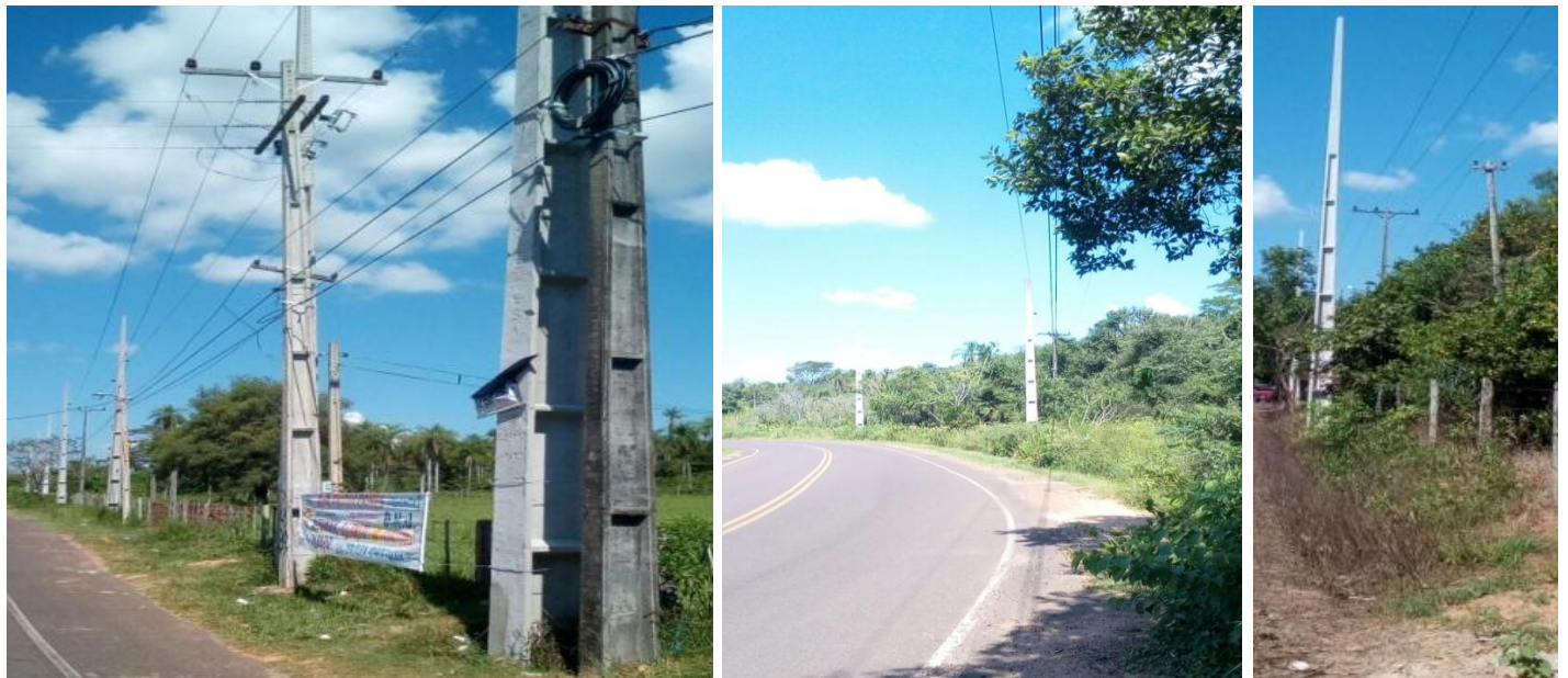
Construcción e interconexión de la Subestación Altos en 220 KV. Construcción de Obras de Distribución, incluyendo el suministro de materiales. Licitación Pública Nacional ANDE N° 1203/2016 - Lote 2 – BONOS II
